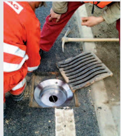
ENVIA CRC instalace přímo na uliční vpust
